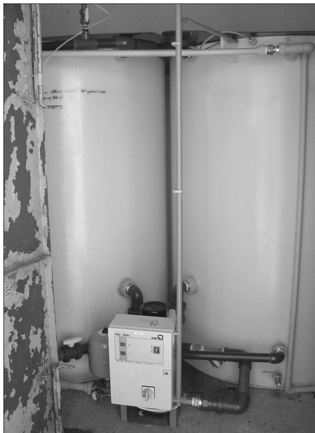
Nové zařízení vodárny - akumulační nádrže o celkovém objemu 5 m 3
