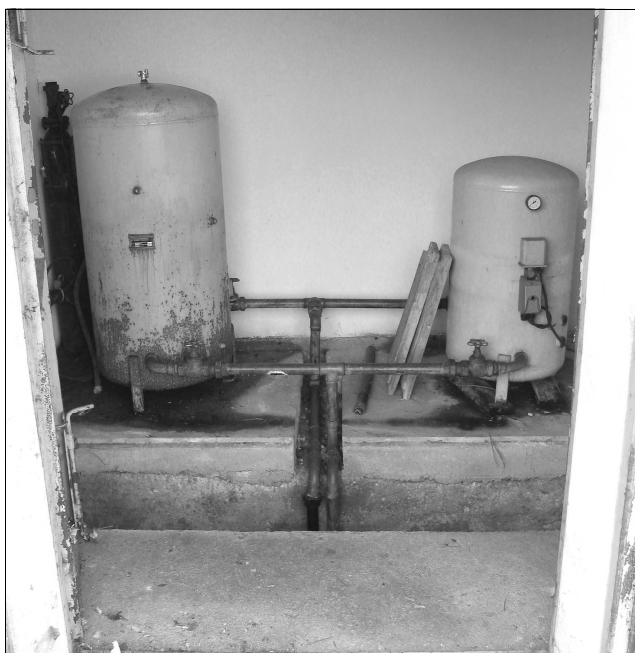
Původní zařízení vodárny
