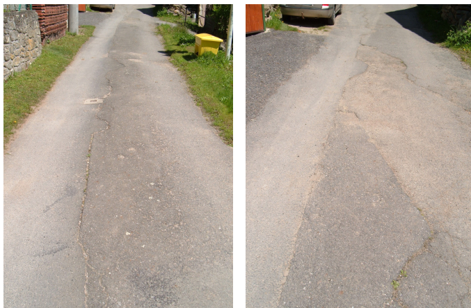
Stav komunikace před opravou
